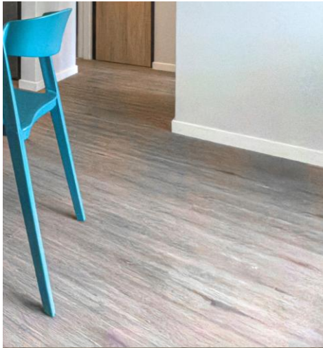
PISO FOTO LAMINADO EN TODO EL DEPARTAMENTO
